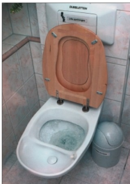
Figure 5. Exemple de toilette no-mix installée en suède (Johansson et al., 2000)
