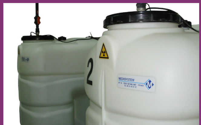
Cuves de décroissance
